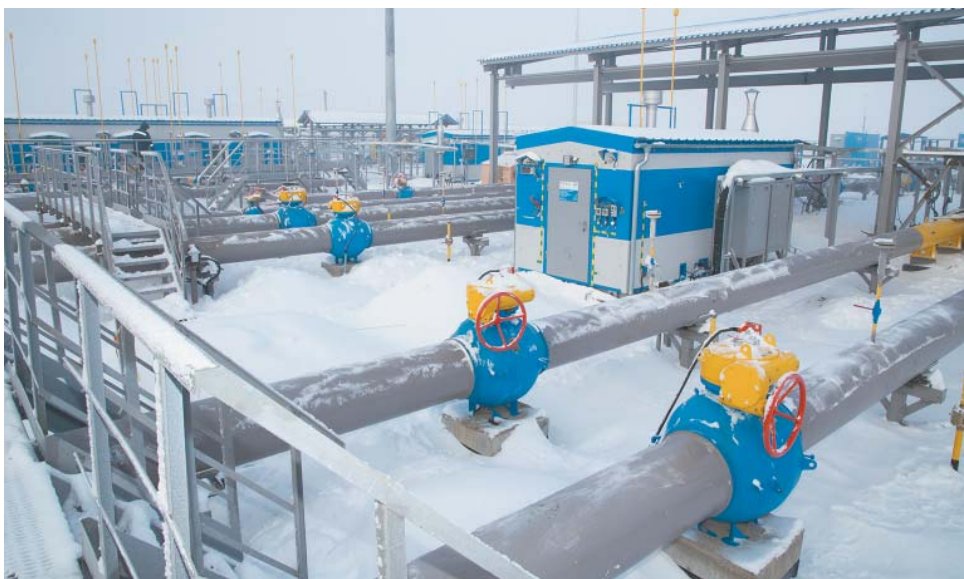
Газораспределительная станция «Лопатино»
