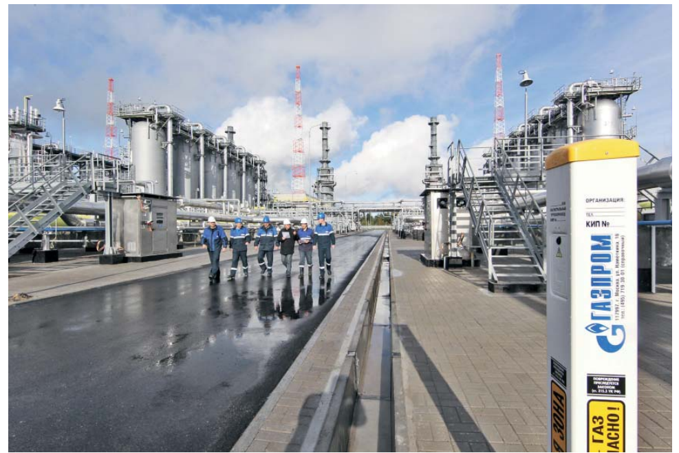
Газ для «Северного потока» поступает из Единой системы газоснабжения России. Компрессорная станция Портовая
