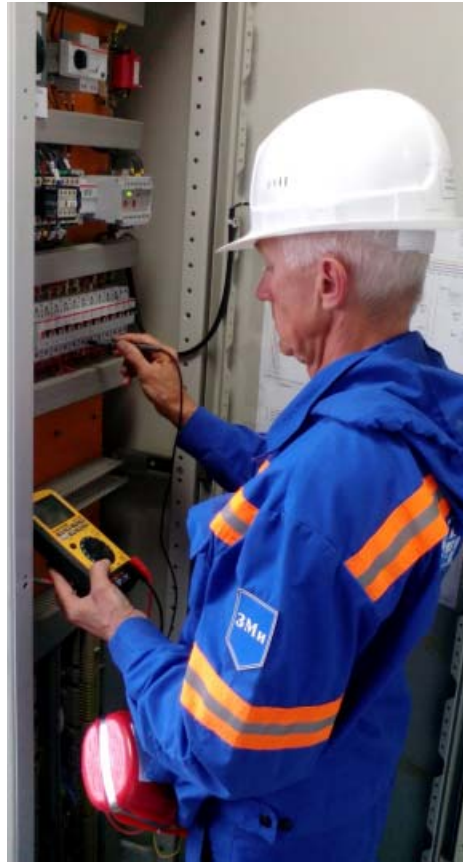
Электромонтёр по ремонту и обслуживанию электрооборудования участка по эксплуатации автономных источников энергоснабжения и передвижных электроустановок ЦДГиГК Е.П. Поляков проводит техническое обслуживание системы бесперебойного электроснабжения УППГ-2
